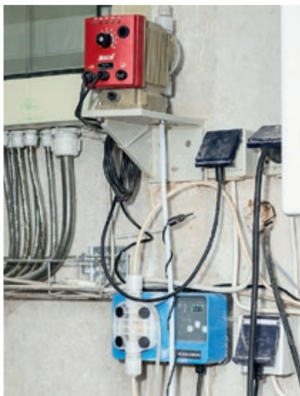
Kleine Pumpe, große Wirkung: Bei der von uns besichtigten Anlage waren täglich nur 150 ml vom pH-Stabilisator zur Halbierung der Abschlammrate notwendig. Fotos: Tovornik
