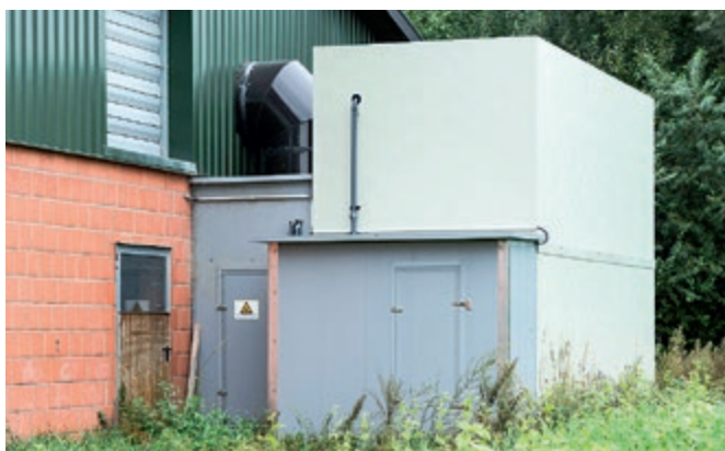
Zur Reduzierung der Baukosten entschloss sich Rimu für eine kompaktere Bauweise: Der Rieselbettreaktor ist deshalb heute um 26 % höher, was laut Gutachten eine um rund 40 % höhere Filterflächenbelastung ermöglicht.
