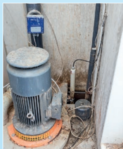
Gleiche Pumpe, besserer Wirkungsgrad: Durch den Sinusbetrieb verbraucht die Waschwasserpumpe nur noch halb so viel Strom wie früher.
